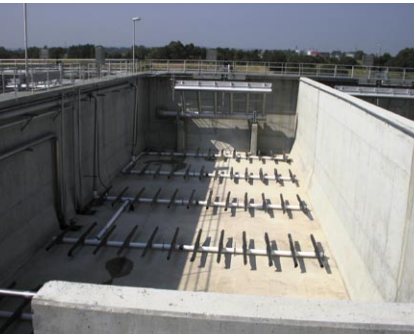
CČN Lendava (42.000 PE) sekvenčna naprava z aerobno stabilizacijo blata in možnostjo doziranja zunanjega vira ogljika (metanol ali odpadna organska topila iz procesa proizvodnje obrata Lek). Naprava je v obratovanju, vendar čisti samo tehnološko odpadno vodo podjetja Lek, saj sistem kanalizacije mesta Lendava še ni zgrajen, zato učinek čiščenja še ni dosegel projektiranih vrednosti.
