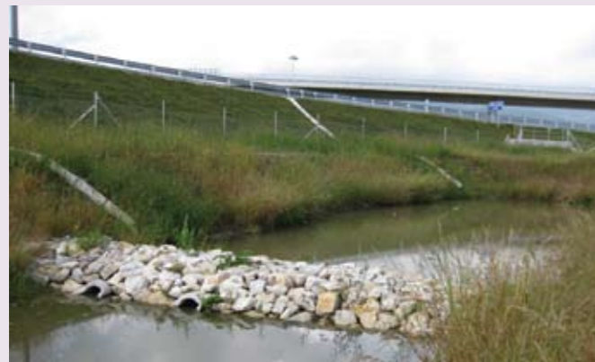
Slika: Dotočne kanalete v čistilni objekt na AC odseku Slivnica Draženci, sklop A
